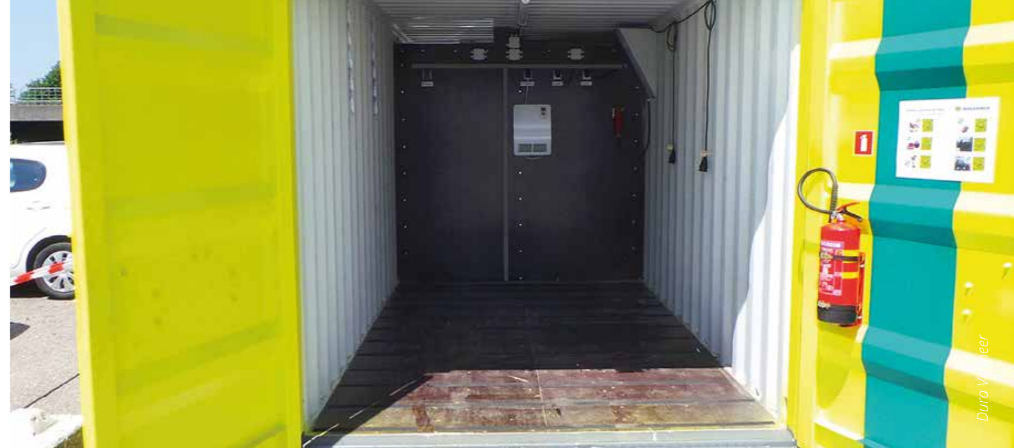
Mobiele oplaadcontainer voor elektrisch materieel van Dura Vermeer
